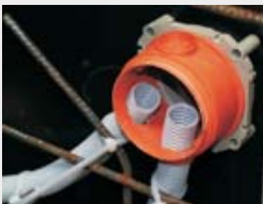
Корпус КВТ и подведенные в него трубы.
